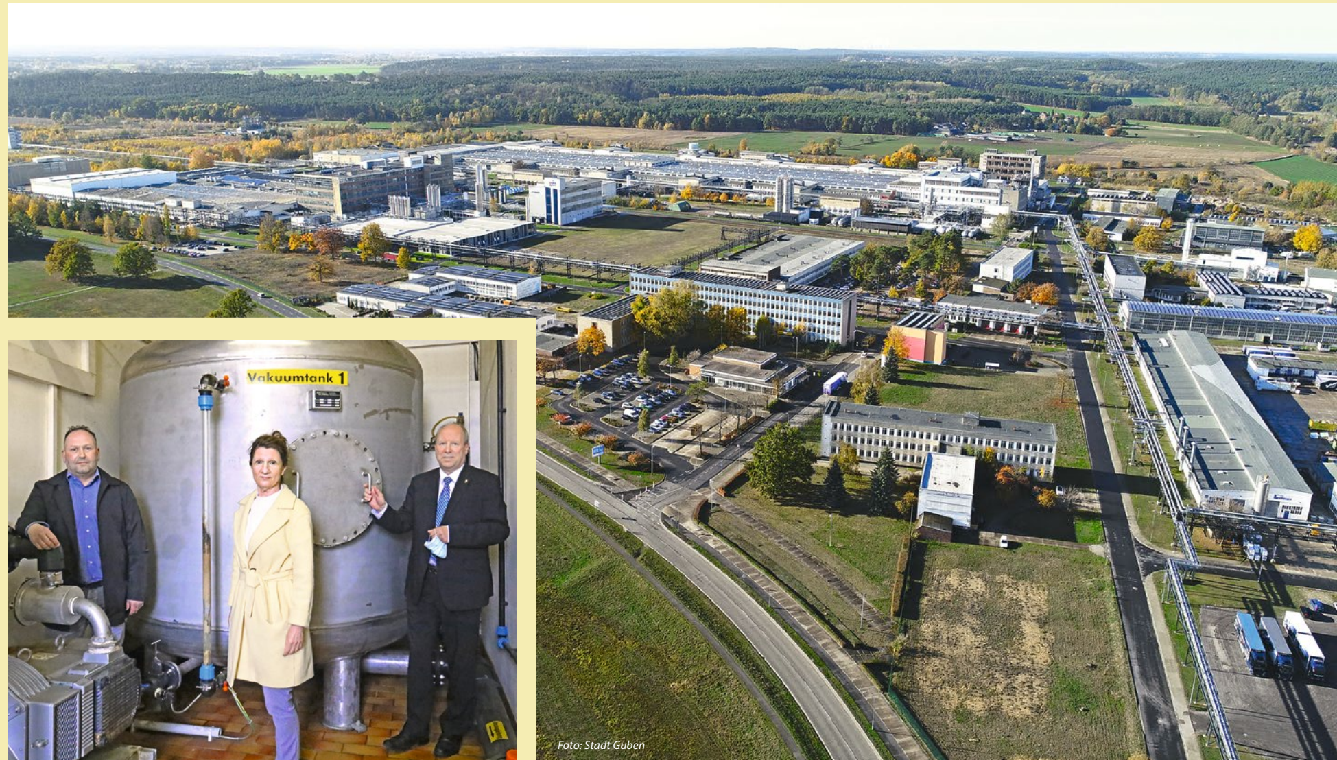
GWAZ-Verbandsvorsteher Ronny Philipp (l.), SWG Geschäftsführerin Sabine-Elvira Karge und Bürgermeister Fred Mahro im Vakuumpumpwerk, dem Herzstück der Abwasserentsorgung im Industriegebiet, bestehend aus vier Vakuum- und drei Schmutzwasserpumpen. Die Pumpen wurden in den letzten Jahren erst erneuert.
